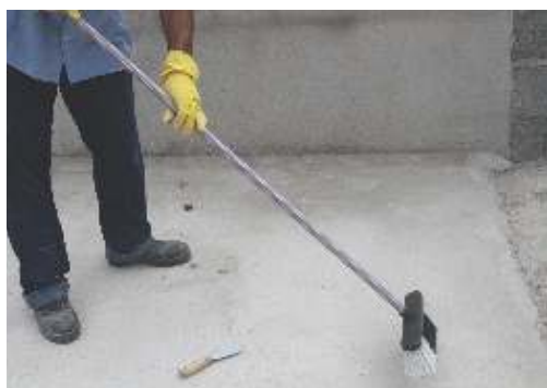
Deixe o local bem limpo, sem resíduos, restos de argamassa, madeiras, pontas de ferro, graxa, óleo e partículas soltas.
